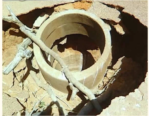
Point d'eau en mauvais état
